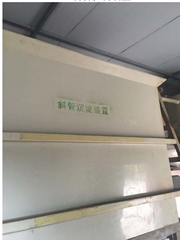
斜管沉淀装置
