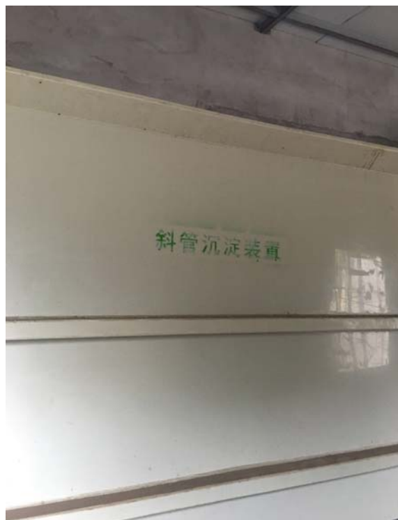
斜管沉淀装置
